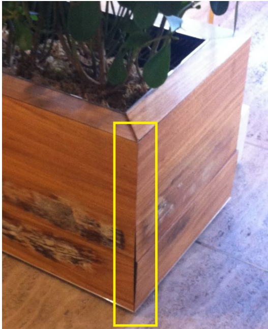
Figura 2 – Cantos sem proteção metálica
