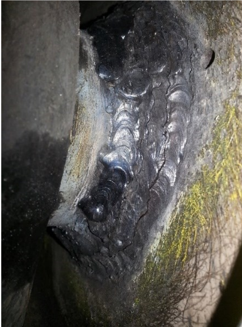
Figura 6 – Solda trincada após manutenção corretiva. Com o tempo mostrou-se ineficaz.
